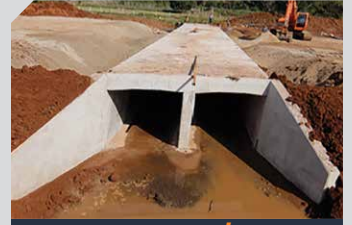
ท่อลอดเหลี่ยม
